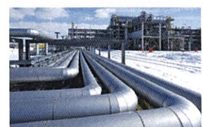
天然ガスプラント（北海道苫小牧市）
