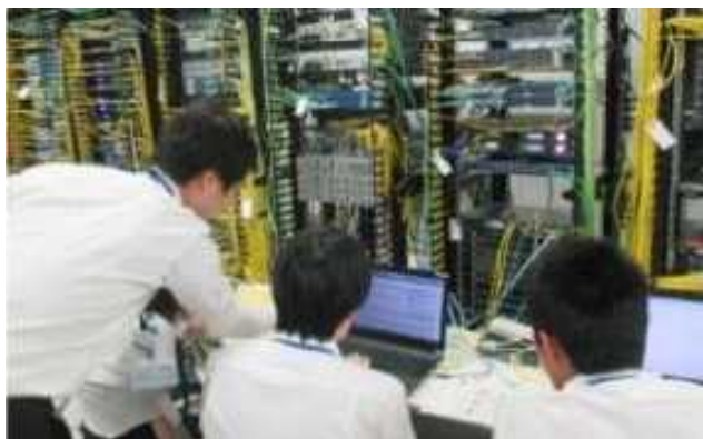
実習の様子(背面のラック内に並んでいる設備がSDCバックボーン設備です)
